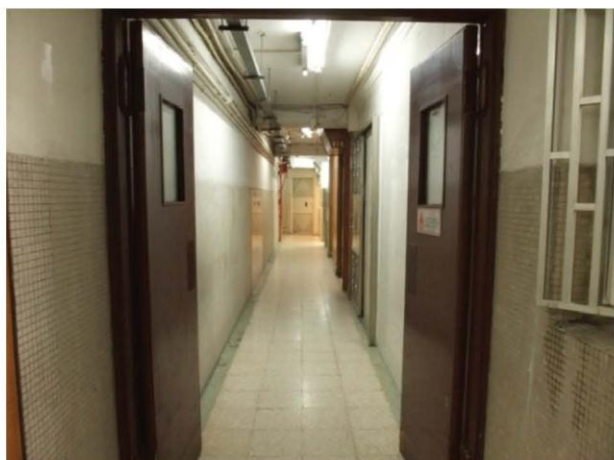
圖7：安裝在走廊的智能調光光管
